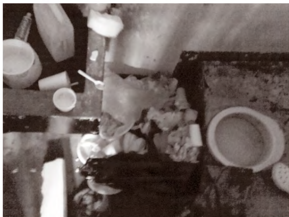
Condiciones de los sanitarios. Fotografía: PDH.
